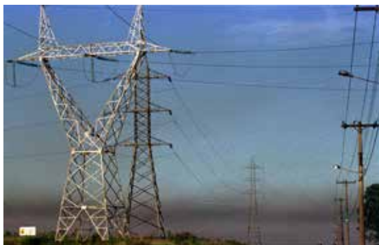
Torre de transmissão
