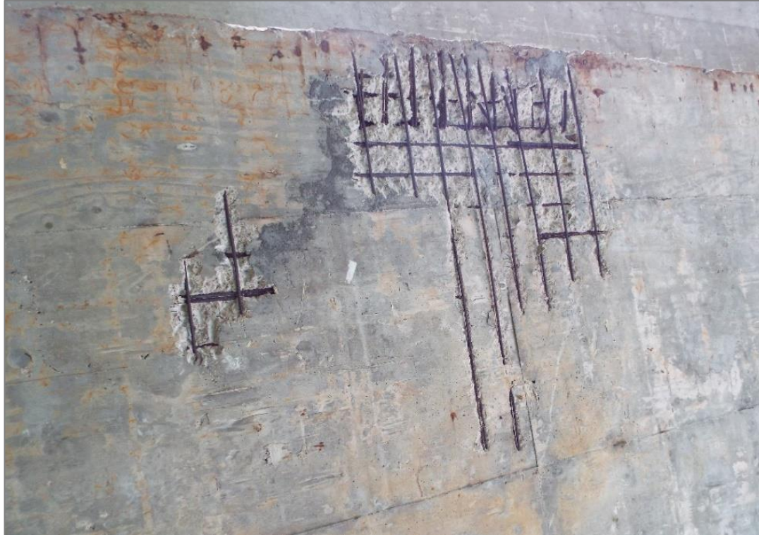
Detalhe do deslocamento de concreto na laje inferior.
