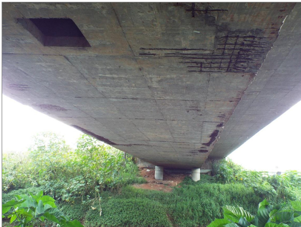
Face inferior da viga caixão – falhas de concretagem na laje inferior.
