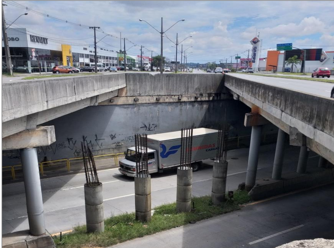
Pilares de sustentação das lajes para o fechamento do vão central da Trincheira da Av. Rui Barbosa
