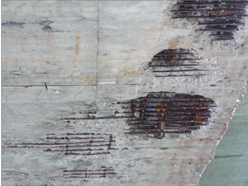
Detalhe da falha de concretagem e deslocamento de concreto na laje inferior.
