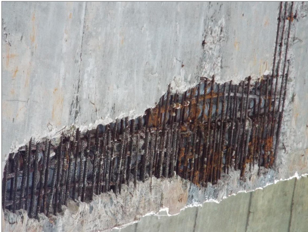
Detalhe da falha de concretagem na laje inferior.
