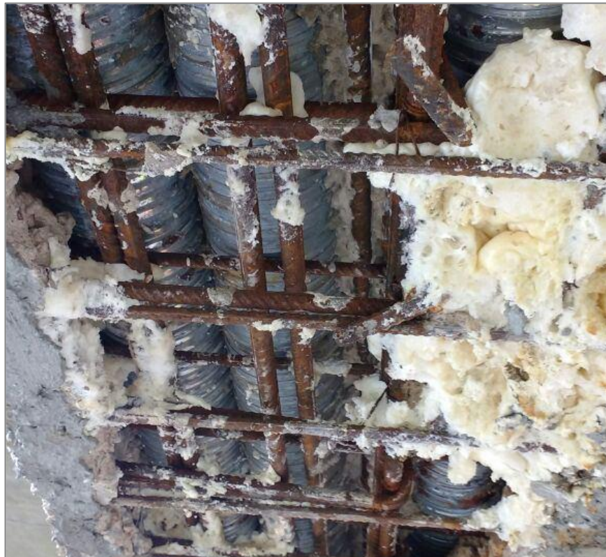
Detalhe da falha na concretagem – Mau posicionamento das bainhas impediu a passagem do concreto.
