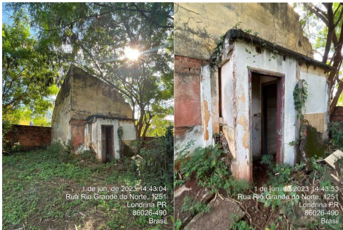
Figura 3 - Edícula em ruínas. Fonte: AMEP, 2025.
